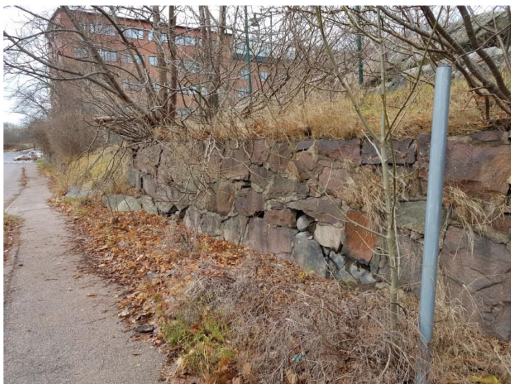
Figur 10. Vegetation ovanpå muren kilar isär stenblock. Foto tagit mot väst.
