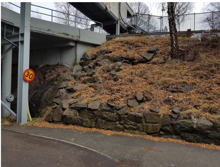
Figur 21. Löst liggande block i anslutning till bro och gångbro.
