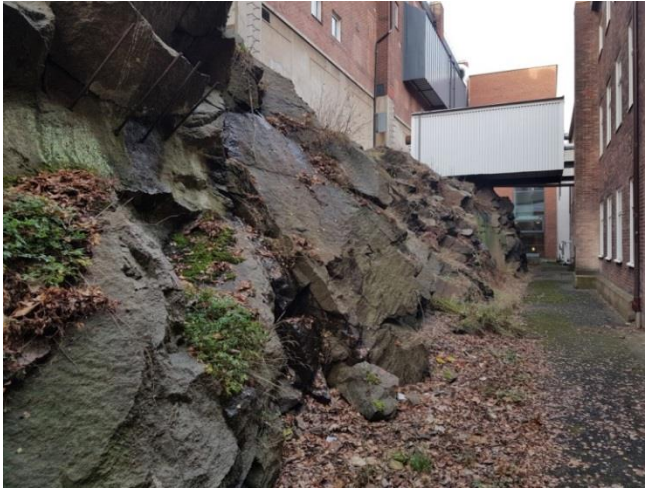
Figur 14. Foto taget mot norr. Norra delen av en längre sammanhängande slänt mellan byggnader med förekommande instabila block.
