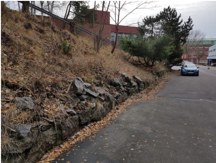
Figur 20. Ovanpå muren ligger lösa block. Foto tagit mot söder.
